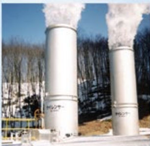
地熱発電蒸気放出用サイレンサー
