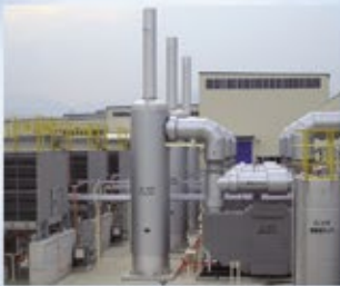
ガスエンジン排気サイレンサー
