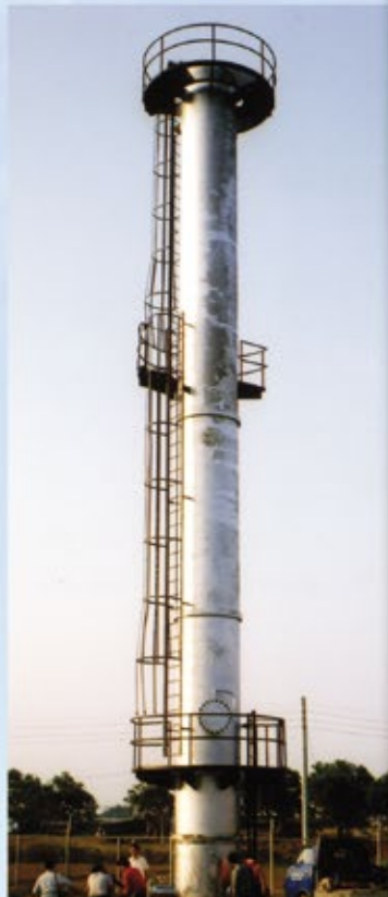
天然ガスパイプライン緊急放散用サイレンサー
