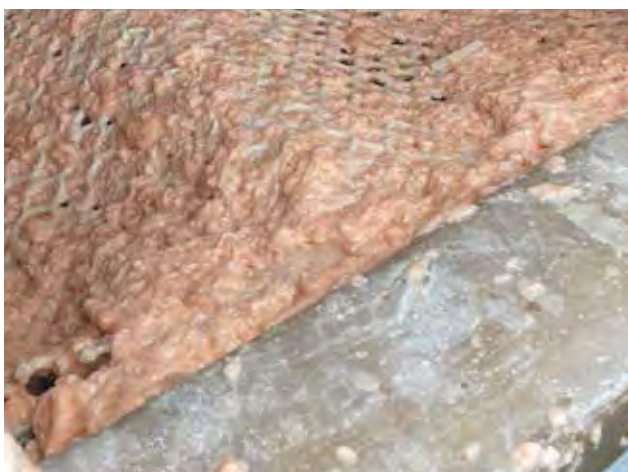
写真1. 充填物受けに溜まったスライム
