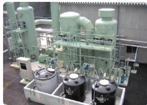
バイオマスセンター堆肥化設備の脱臭
