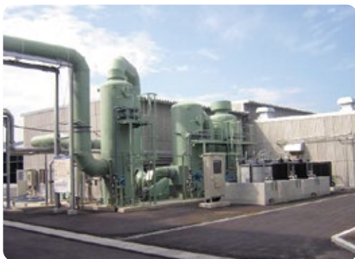
バイオマスセンター堆肥化設備の脱臭
